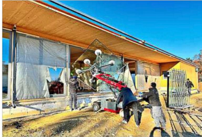
Anfang dieser Woche ging es dann beim Neubau weiter und die großen, modernen Fenster wurden eingesetzt. – Fotos: TSV Simbach
