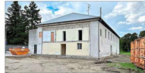
So sieht das Grundstück im Moment aus. Den alten Eingang der Jahnturnhalle, wie er vor den 70er Jahren aussah, kann man sich jetzt gut vorstellen. Jetzt geht es innen mit der Sanierung weiter.
