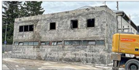
Entkernt bis auf den nackten Beton: Wie ein Bau-Gerippe aus längst vergangener Zeit sah der Anbau kurz vorm Abriss aus. Der TSV war hier mit viel Eigenleistung gut vorangekommen.
