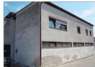
Der Anbau mit Duschen, Umkleiden und Toiletten sowie Hausmeisterwohnung entstand in den 70er Jahren. Er wird abgerissen.
