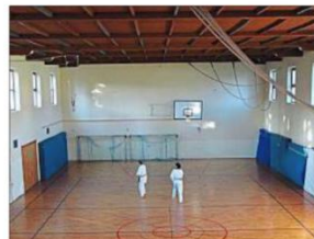
Der Holz-Parkettboden ist bald Vergangenheit. Schon jetzt freuen sich die Sportler auf einen modernen Schwingboden.
