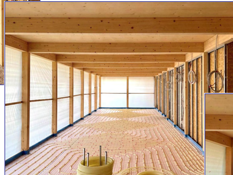
Schneckenförmig gelegte Polyethylen-Heizrohre
